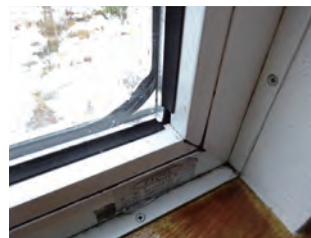
1989年に竣工した建物の2020年の様子。ガラスビードが切れて外れている
