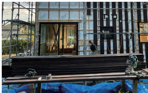
塗料が乾燥したところで木板を張っていく。木板の反りを抑えるために裏面にも塗料を塗っている
