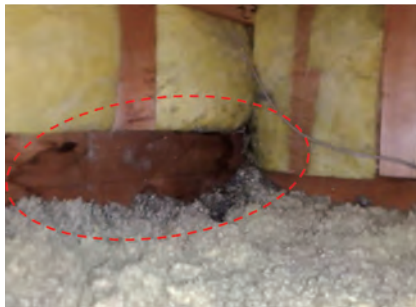
1995年に建てた中古住宅の2020年時点での天井断熱の様子。隅部に雨漏りの跡がある
