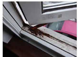
写真左と同じ建物。サッシの煽り止めが破損している
