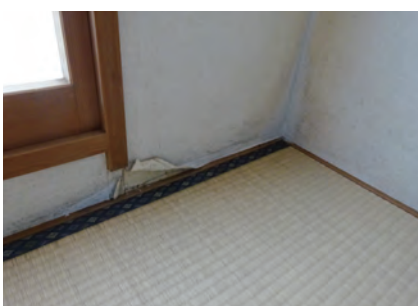
和室の隅部にも内部結露が生じている。気流止めなどが不十分だと推察される
