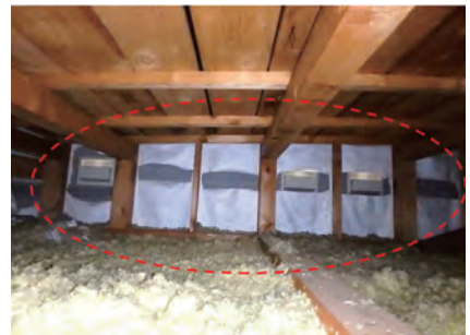
小屋裏の様子。透湿防水シートが途中で切れており、雨漏りの原因になった可能性がある
