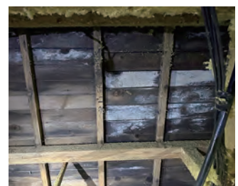
小屋裏の野地板の様子。結露で雨漏りのような吸水の跡がある
