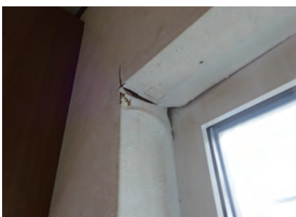
室内の窓まわりの様子。内部結露により、仕上げ材がめくれている
