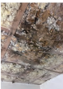
過去のリフォームにより、天井裏に結露を引き起こした事例
