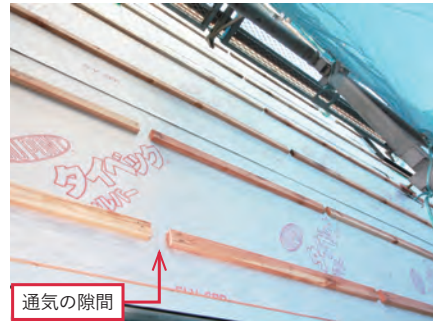
横胴縁の場合、胴縁に隙間を設けて通気を確保。 エアホール胴縁を用いてもよい
