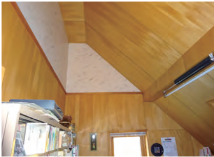
北海道指定第1号のウッドタウンプロジェクト・旭川市「ウッドタウン緑が丘」に建つ住宅。1990年竣工で写真撮影時は2017年。この時点で気密測定をしたところC値2.0を下回った
