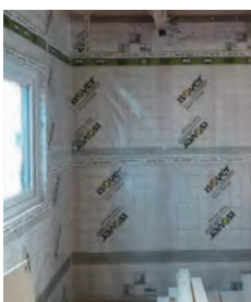
可変性透湿シートを用いた例。夏型結露のリスクは非定常計算で算定(写真:住まい環境プランニング西日本)
