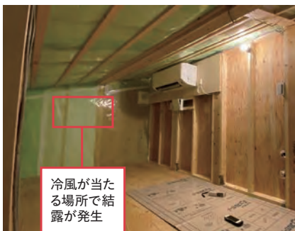
小屋裏にエアコンを設置したことによる夏型結露例。冷風が直接当たった部分で結露した
