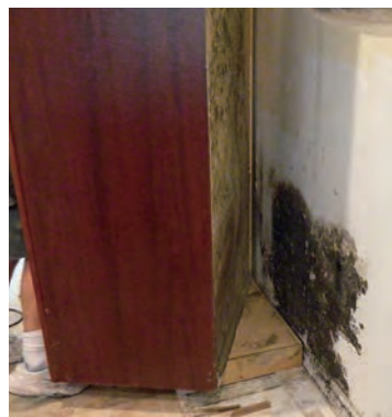
家具の裏の結露例。結露のメカニズムは押し入れ型結露と共通
