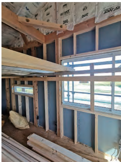
耐力面材に「タイガーEXハイパー」を張った住宅。石膏ボード系の材料なので透湿抵抗が非常に低く、内部結露のリスクを抑えられる
