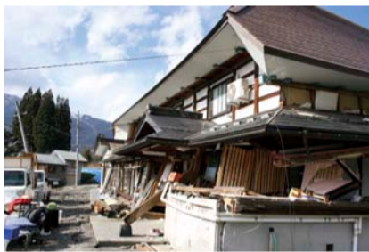
大きく傾いた住宅。歴史ある住宅が多く残る集落で、どのように安全を図るのか
